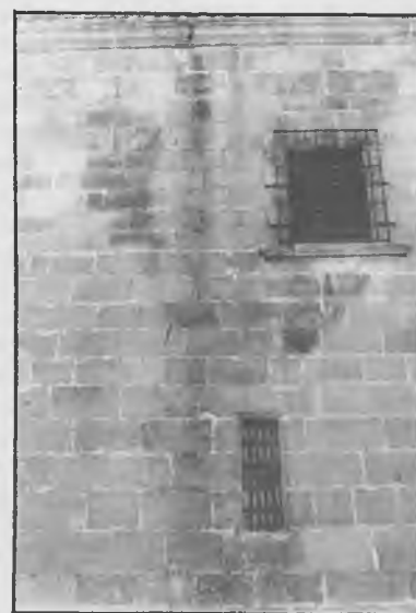
En el centro de la imagen, se aprecia las graves humedades que aquejan a la cerería
