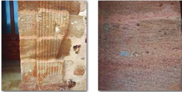
Figura 24. Vista de detalle de una de las entradas a la iglesia de la Visitación de Nuestra Señora donde se pueden observar la diferencia de materiales.
