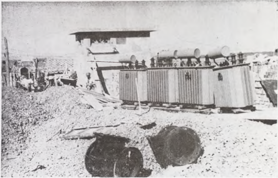
Los transformadores en la estación elevadora, que ya han sido instalados y están dispuestos para su inmediata utilización.
