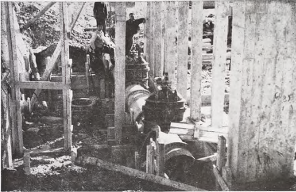
Dentro de la caseta de maniobras del nuevo depósito, dos llaves de entrada y salida que están completamente terminadas.
