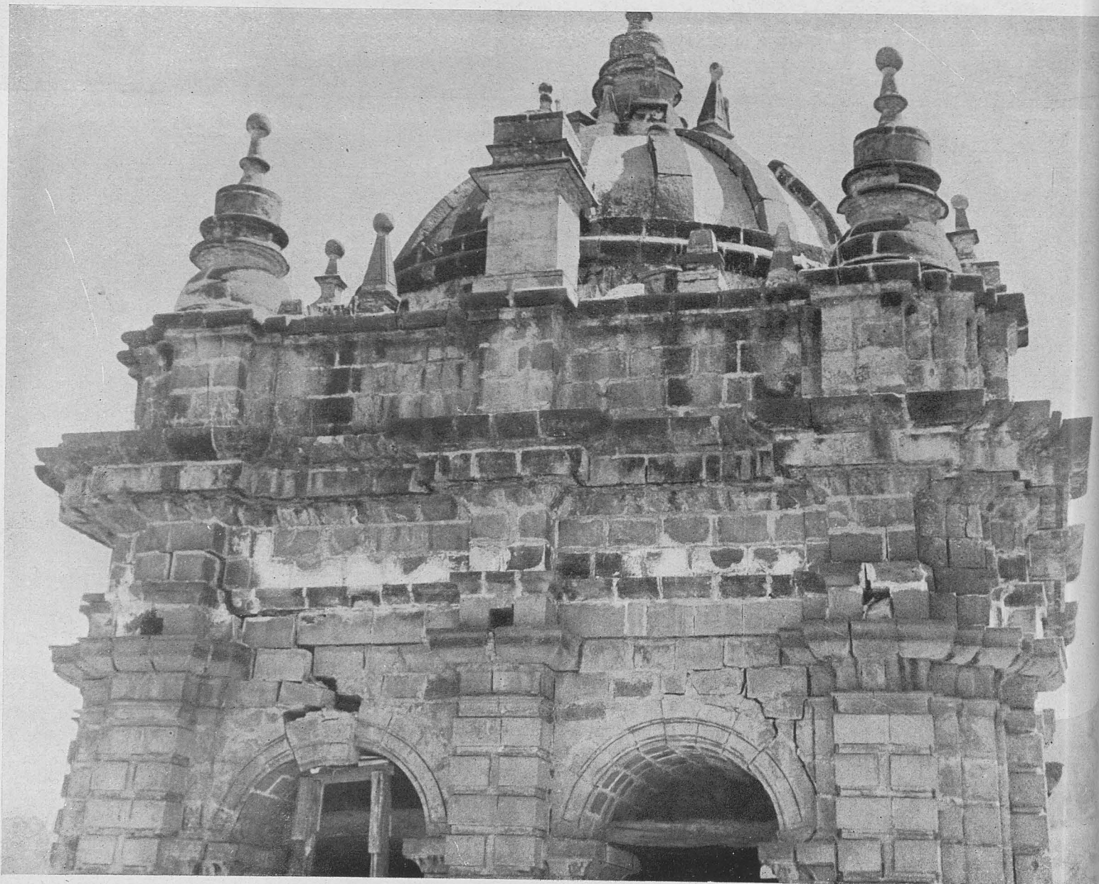
Catedral del Cuzco. Torre derecha. Destrozos.
