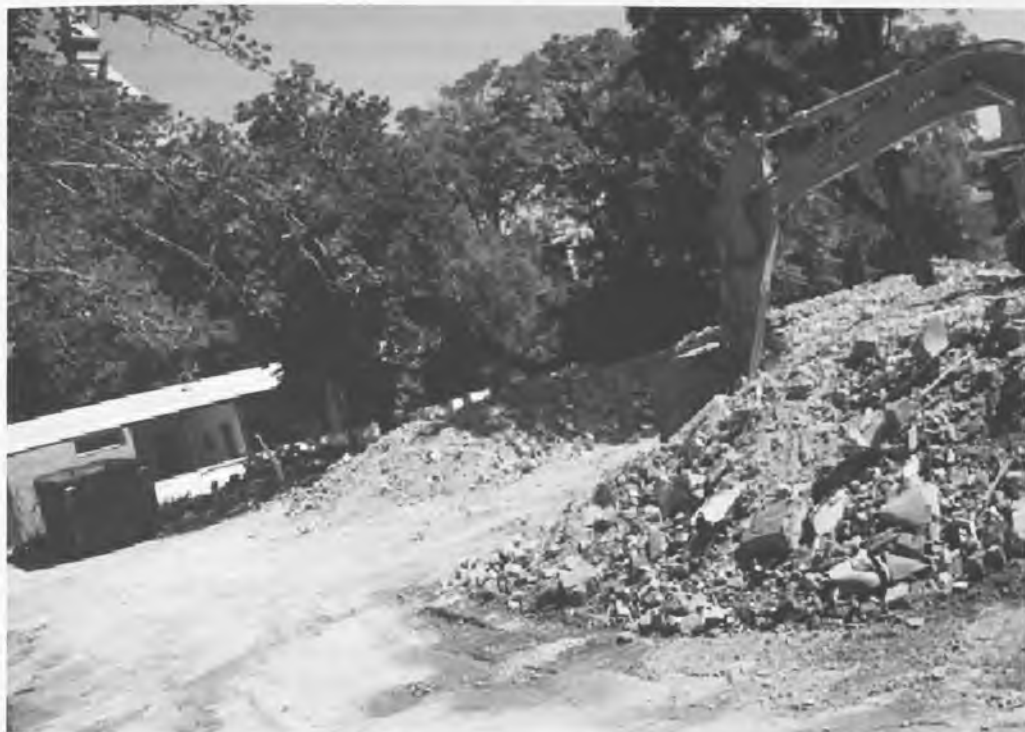
Foto publicada en El Decano de Guadalajara (27 de junio de 2008) de las obras de demolición del antiguo colegio.
