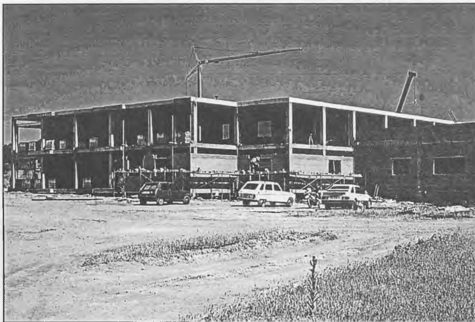
Las obras de la nueva Residencia, lleva un buen ritmo en su construcción como podemos observar en la foto
