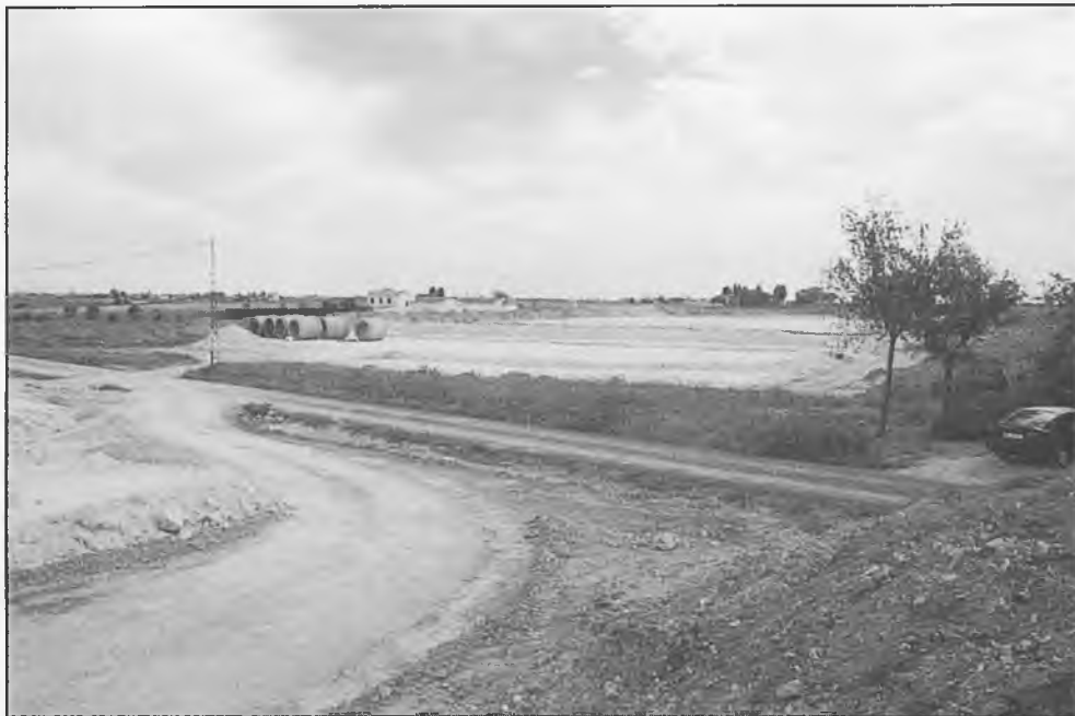
Se ha aprobado el tramo de autovía Daimiel a Manzanares, con un plazo de ejecución de 40 meses
