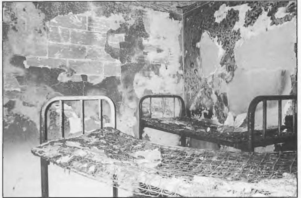
Estado en que quedó la habitación donde se inició el fuego en la Cruz Roja
