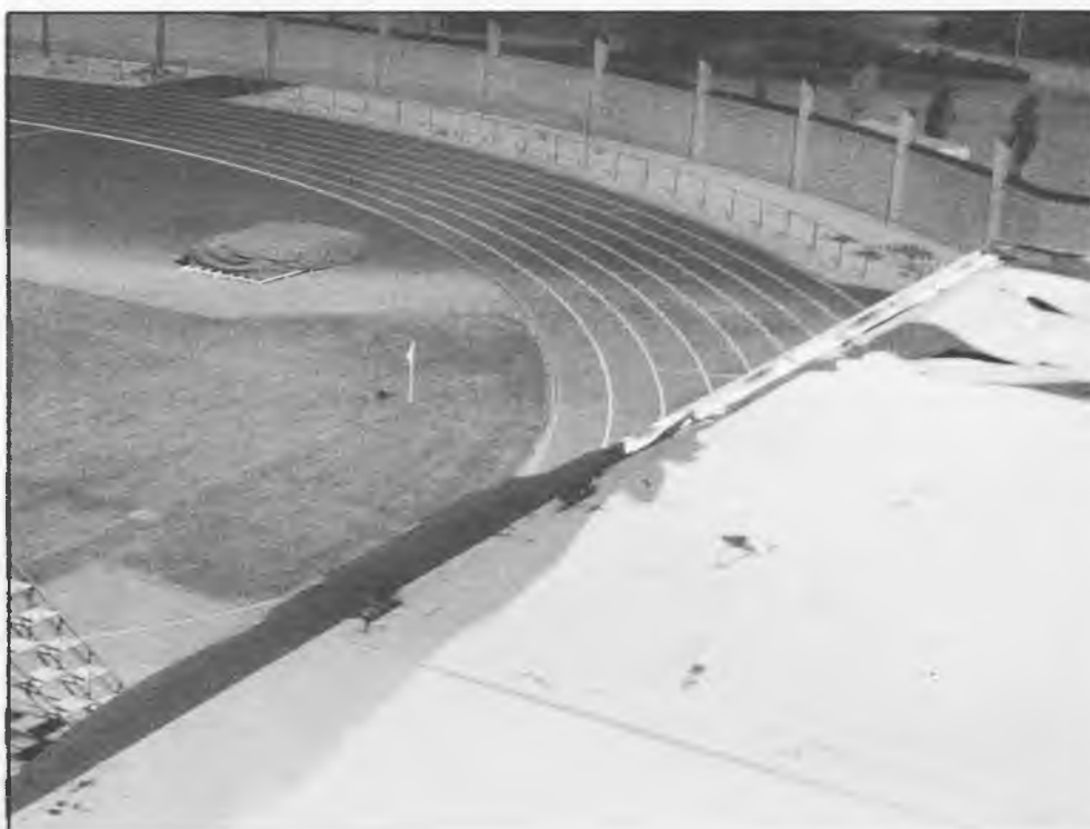
Pronto se instalará una nueva chapa de recubrimiento en el Estadio Municipal
