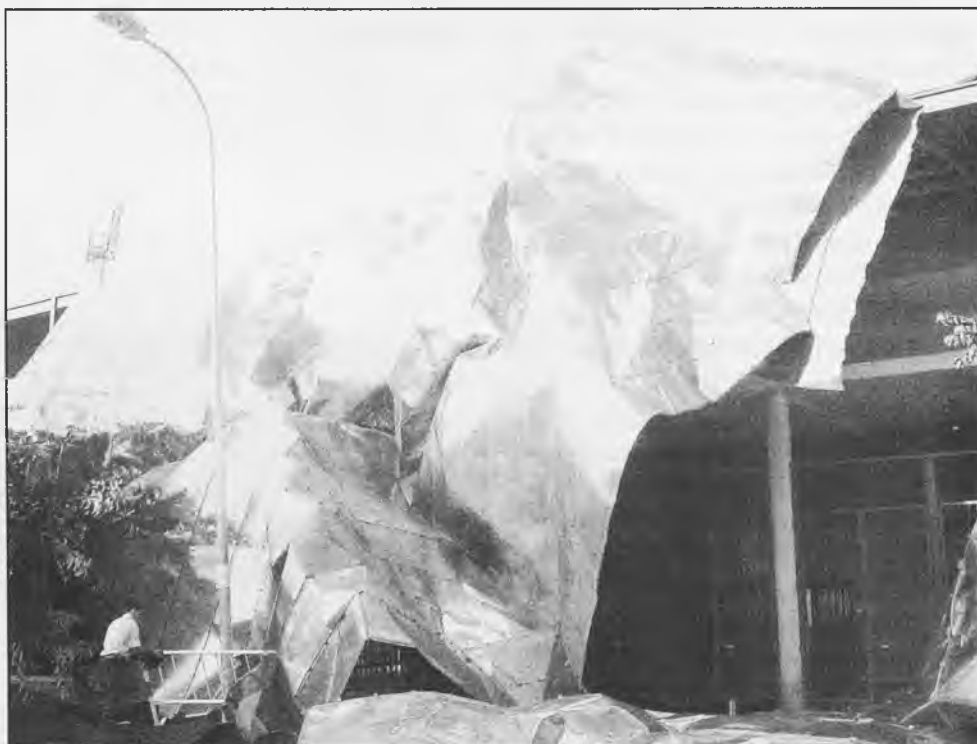
¿Quién pagará el arreglo de la cubierta del Estadio Municipal?
