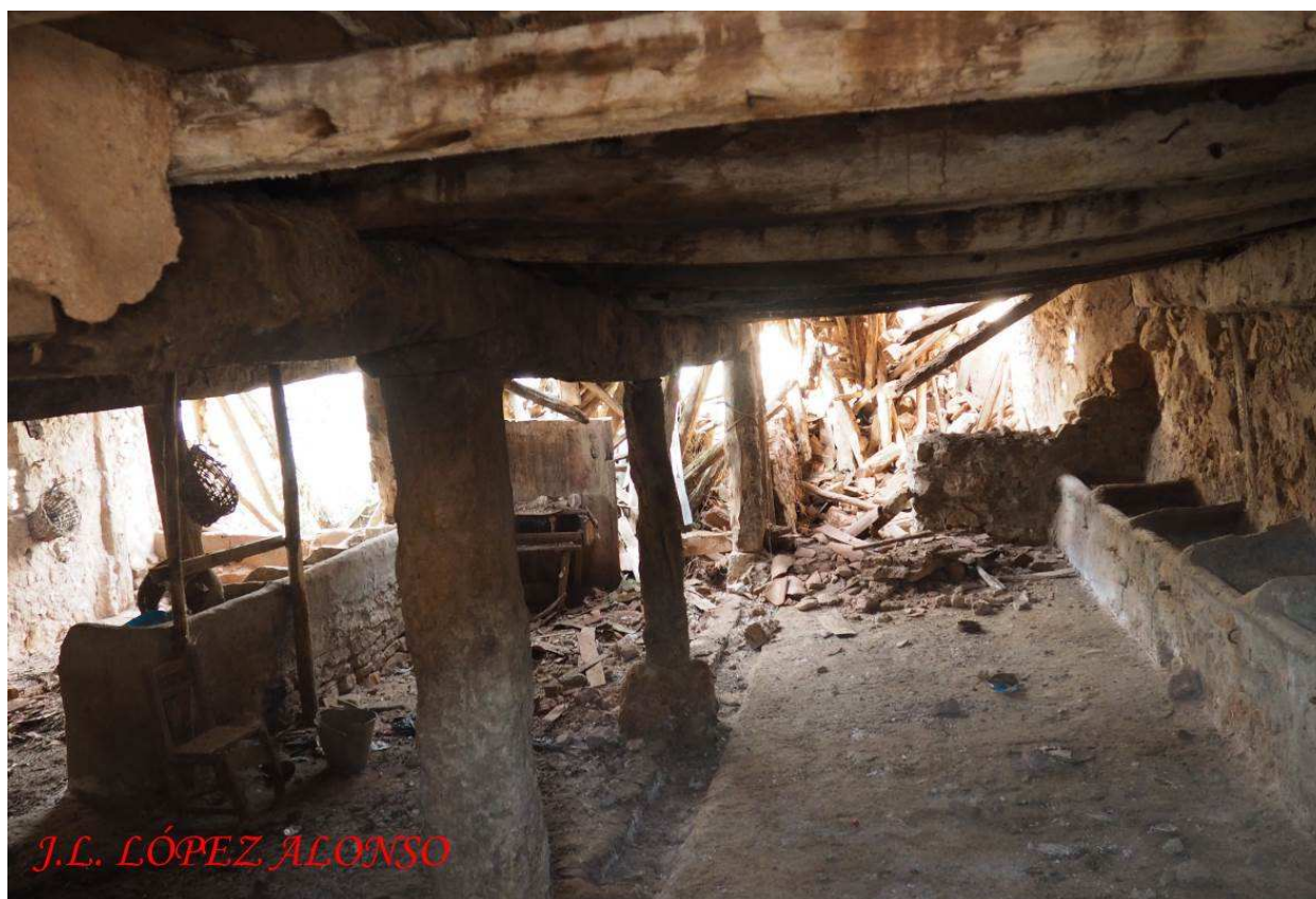
ACTUAL ESTADO RUINOSO DEL INTERIOR
