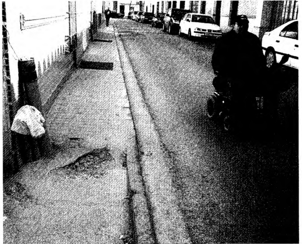
Las obras en las aceras obligan a transitar peligrosamente por la calzada.
