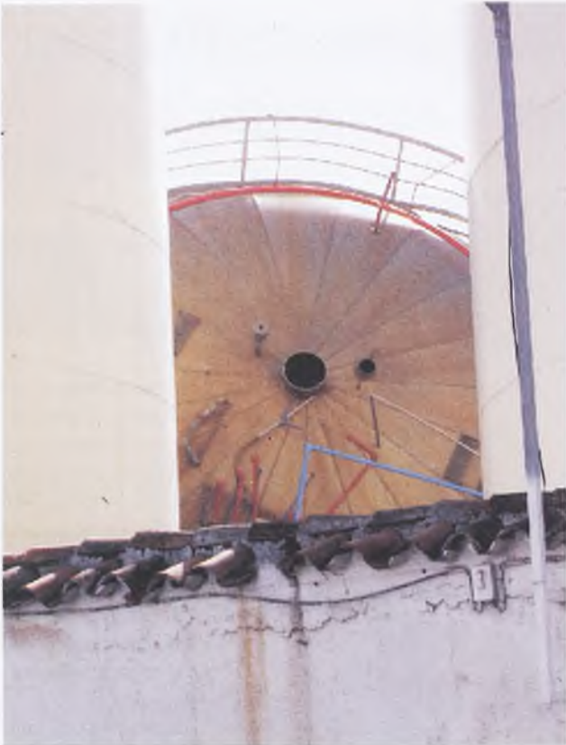
Estado en el que quedó el depósito afectado.
