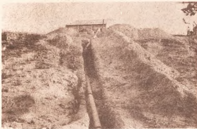
Vista de la conducción de agua del pozo núm. 3 al depósito propiedad del Ayuntamiento de Elche por presión forzada.
