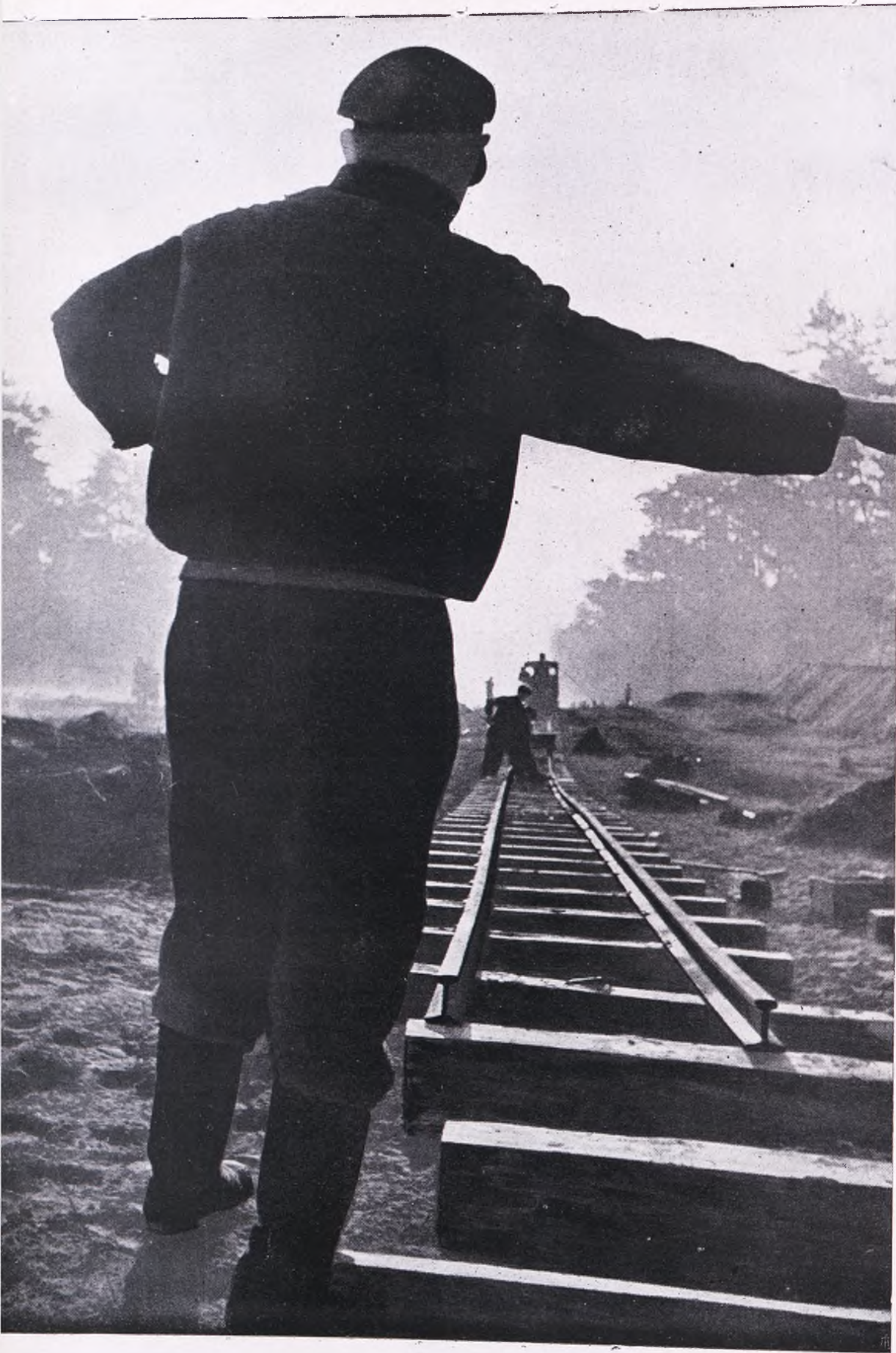
Los obreros venidos de la ciudad, abren en las entrañas de las tierras vírgenes, el cauce, por el que más tarde se deslizará la canción de hierro de los ferrocarriles
