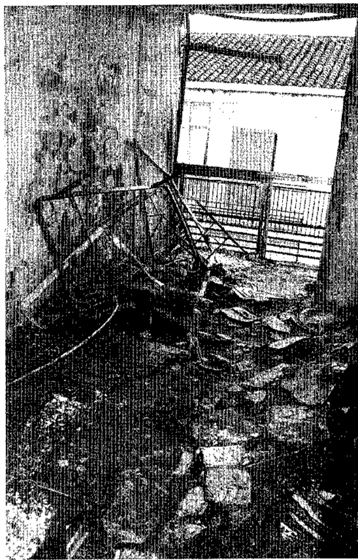
Un incendio destruyó una vivienda alquilada por estudiantes.
