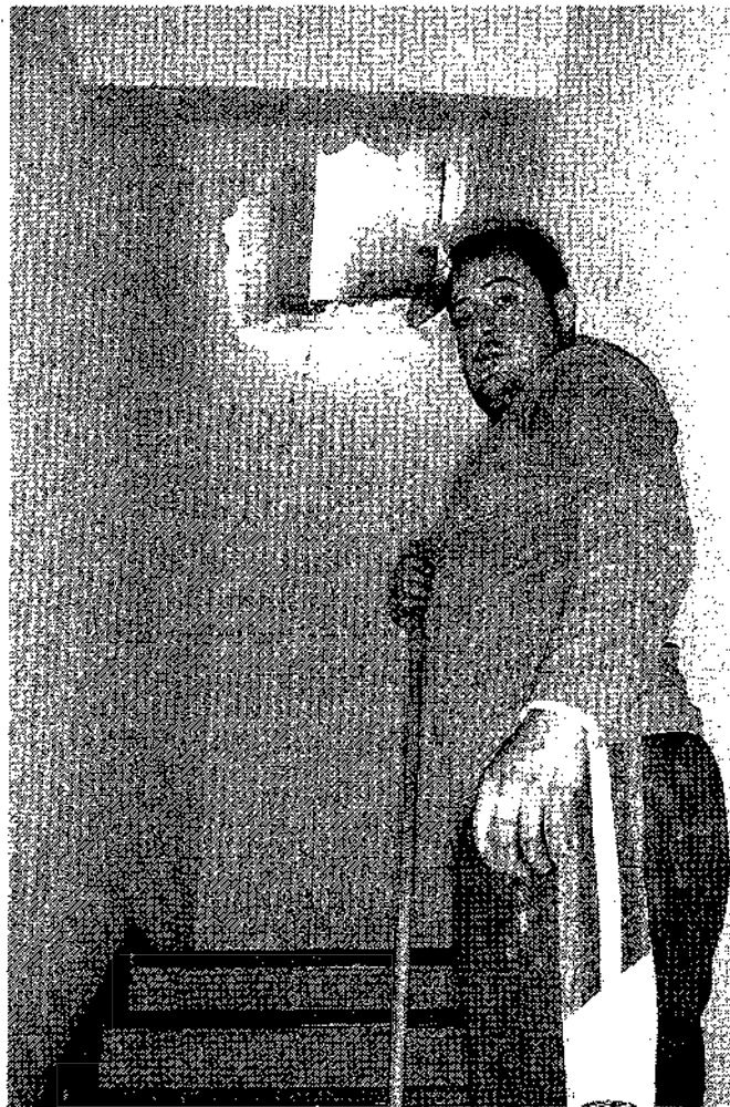
Al fondo, el hueco que quedó tras ceder la estructura.
