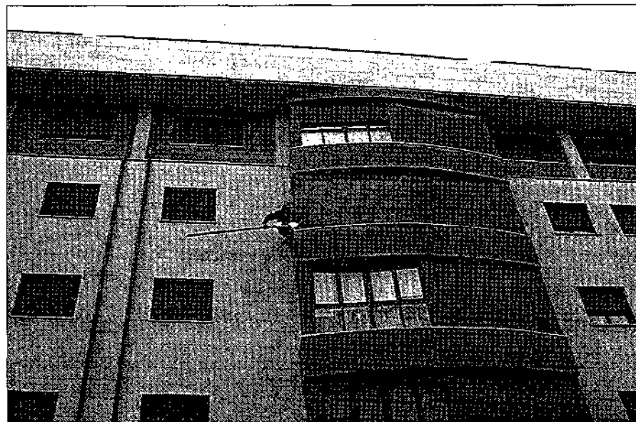
Una de las persianas de la imagen se desprendió y cayó a la vía pública en Miguel de Cervantes. Parte de otra del mismo edificio hubo de ser desmontada por los bomberos ante el riesgo de que se precipitara a la calle.
