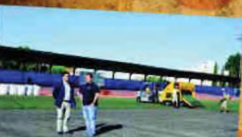
Comienzan las obras de renovación del césped del campo de fútbol Nuestra Señora del Carmen
