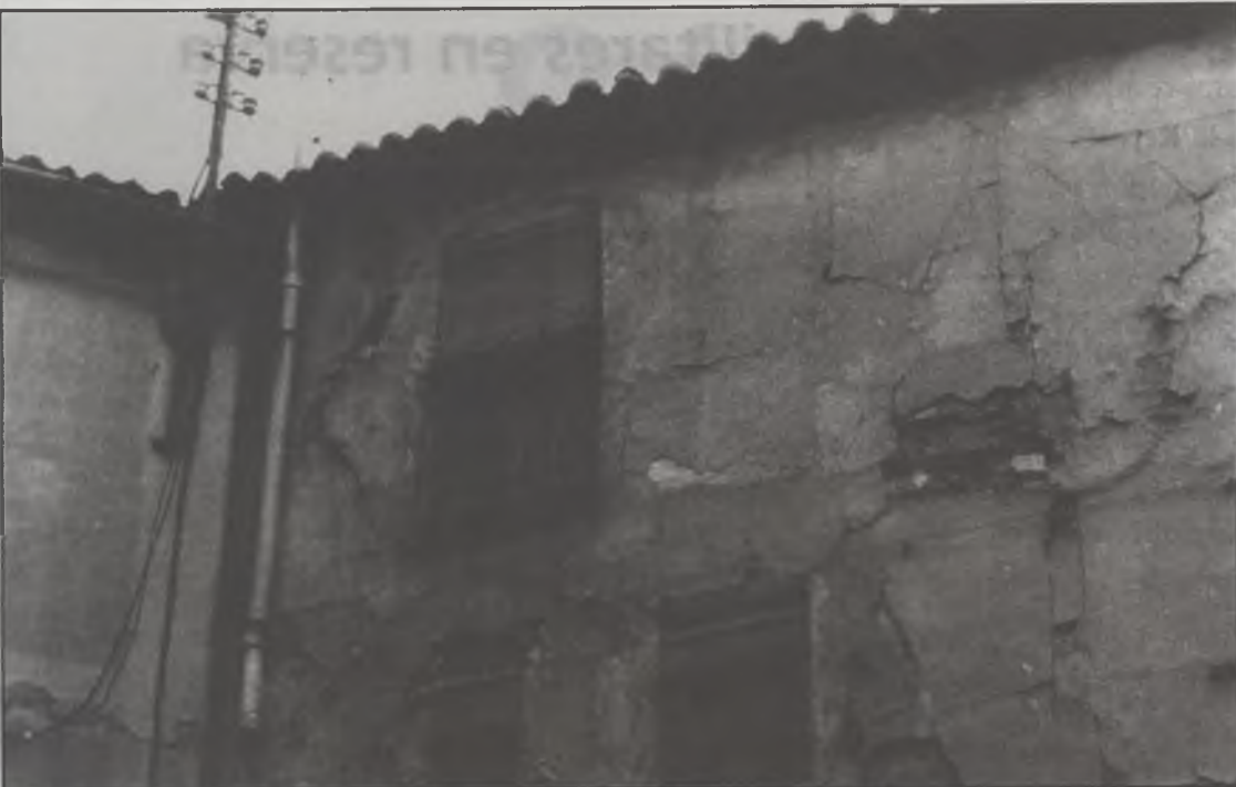
La eliminación de cables y antenas es uno de los puntos básicos del Plan.
