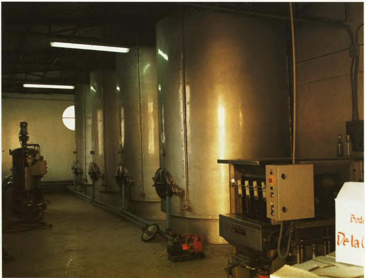
Batería de depósitos isotérmicos
