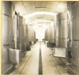
Instalación completa de depósitos isotérmicos para la estabilización del vino a bajas temperaturas en Virgen de las Viñas (Tomelloso)
