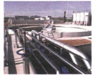
Tratamiento de aguas. AN.
