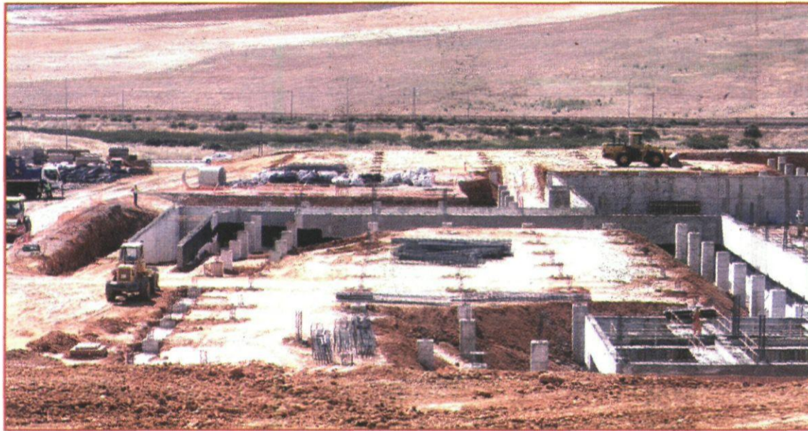
Previcon realizó los trabajos de coordinación de seguridad y salud en la obra de Silicio Solar II, en Puertollano. / LT
