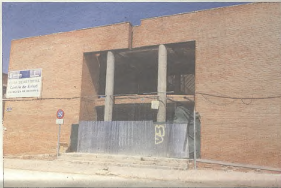
El edificio se deteriora, abandonado tras la paralización de la obra por parte del Gobierno de Cospedal.
