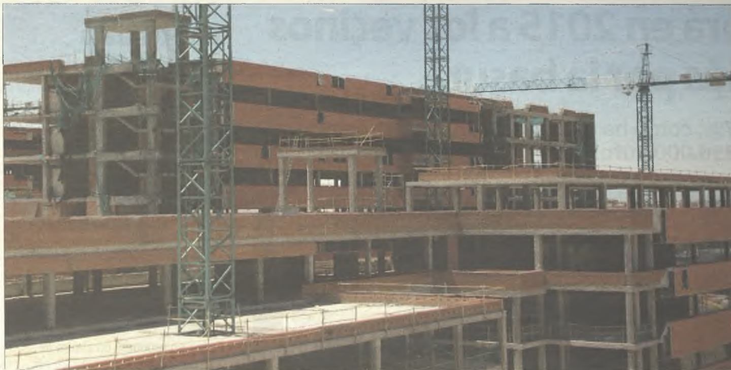
Estado actual de las obras del nuevo hospital de Guadalajara, paralizadas desde hace tres años.
