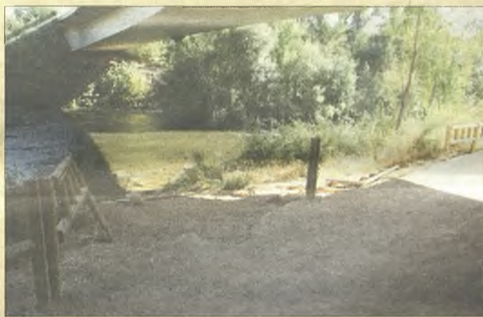
> Y así cuidan la zona de paseo en la ribera del Henares. Muchos meses hace que esto está así y nadie hace nada por remediarlo.
