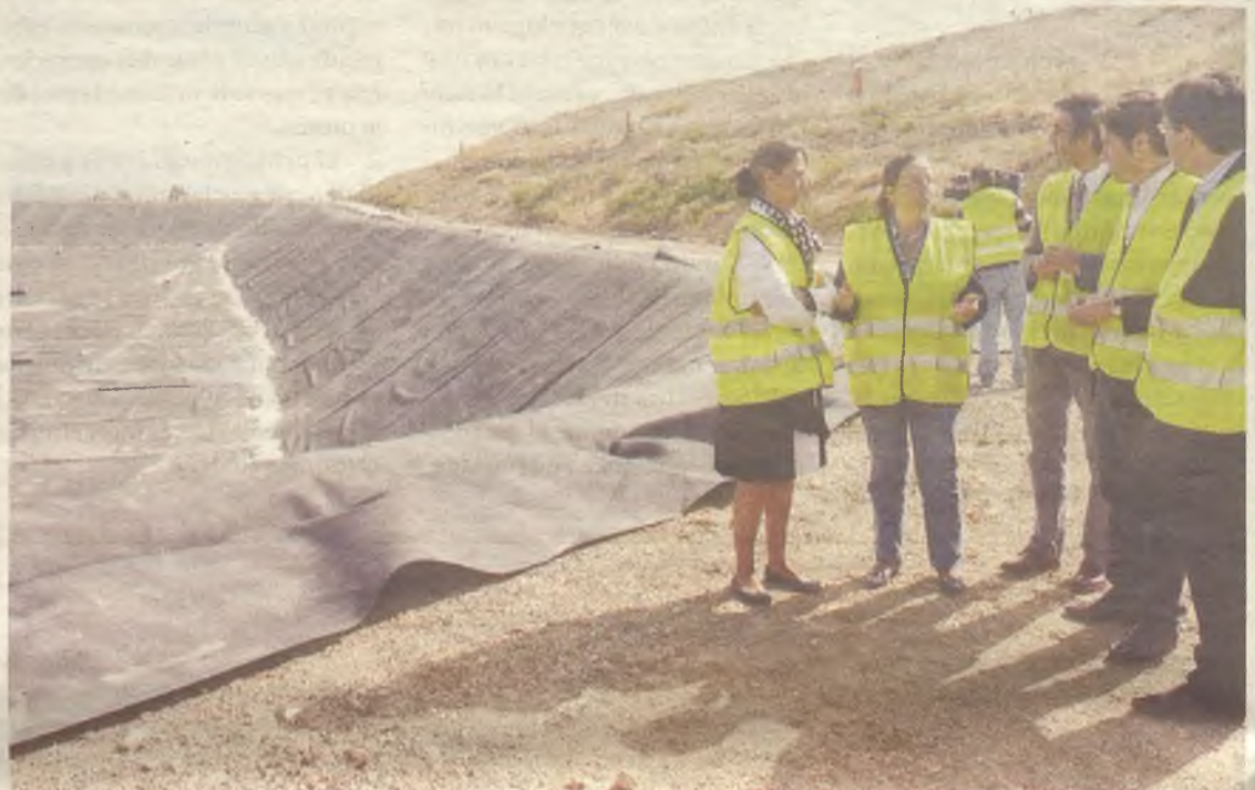
La presidenta de Diputación ha visitado la obra para conocer de primera mano los progresos de la misma.
