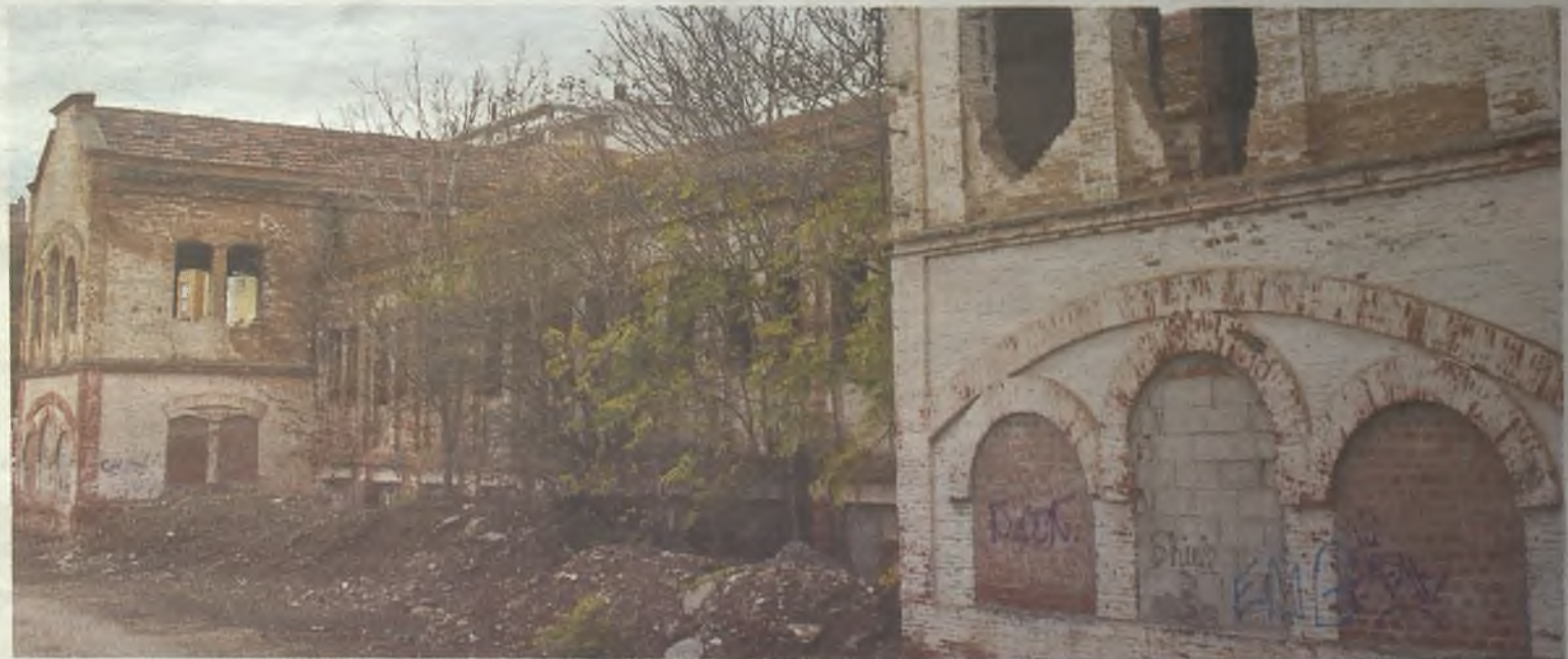
En este estado se encontraba el Cuartel del Henares antes de los trabajos de rehabilitación./J. Roperó
