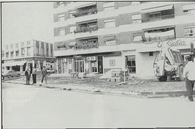
PARADA DE TAXIS. Torrijos está en obras, ahora que se acercan las elecciones, y su alcalde, el popular Miguel Angel Ruiz Ayúcar, ha previsto instalar la nueva parada de taxis en este lugar, que al parecer es del agrado del colectivo que ejerce los trabajos de desplazar a los viajeros.
