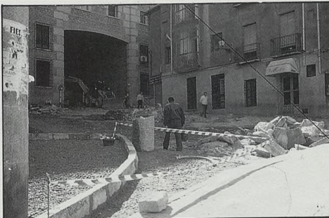
OBRAS. Cada vez son más las obras que se están realizando en nuestra ciudad y que provocan cortes de tráfico. En esta ocasión es la Plaza de la Magdalena de Toledo la que está cortada al tráfico rodado hasta que finalicen las obras de reafirmación de empedrado.
