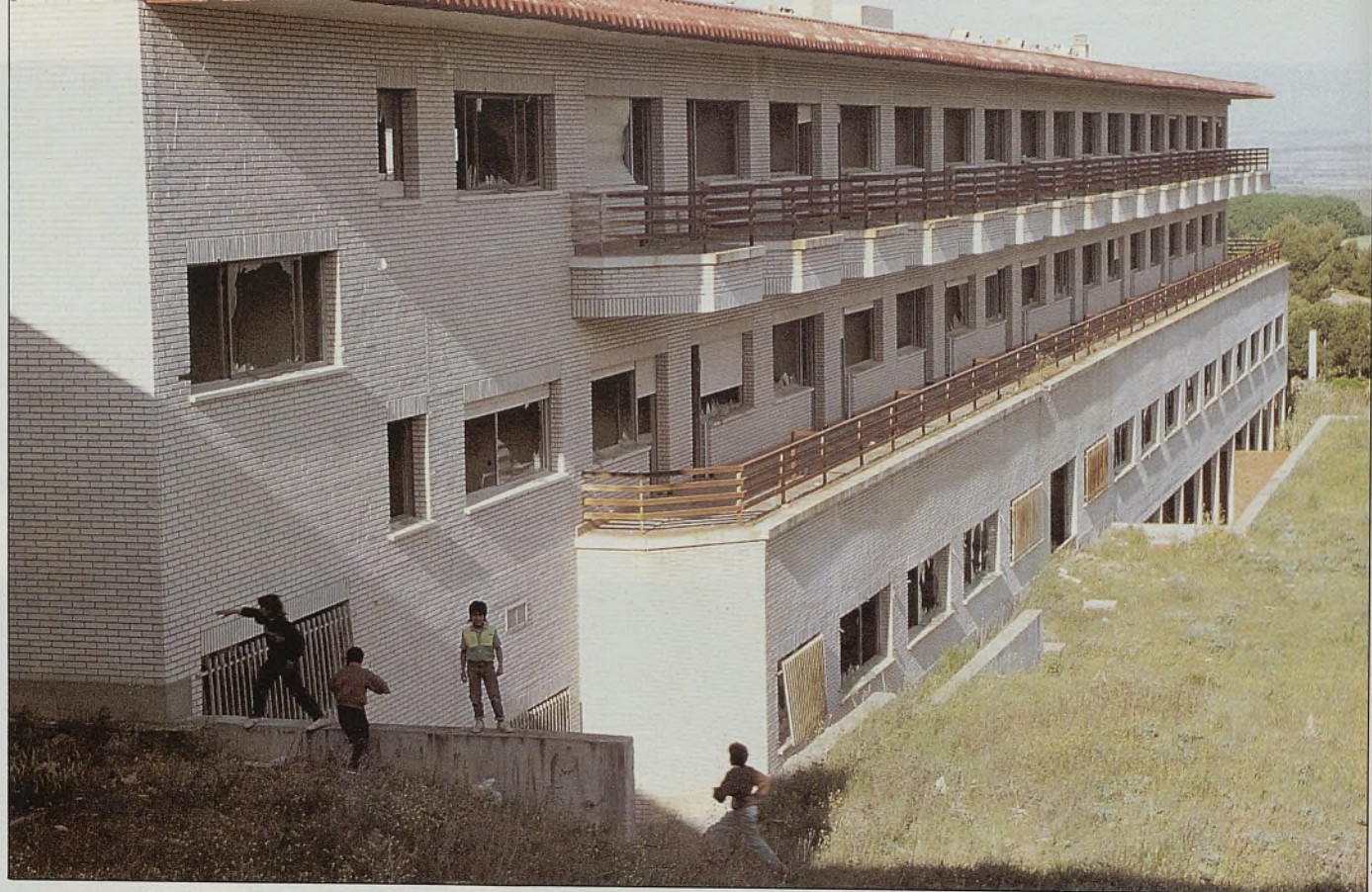
El centro cuenta con 12.000 metros cuadrados construidos, y durante todos los años que ha estado abandonado, ha sufrido multitud de saqueos.
