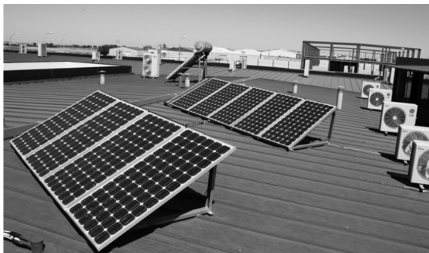
▲ Paneles solares instalados por los alumnos en el tejado del Centro de Nuevas Tecnologías.
