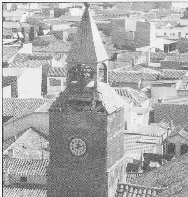
Estado lastimoso de la Torre del Reloj, aún sin restaurar.
