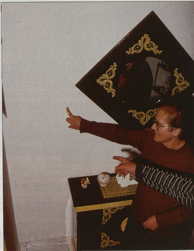
Gloria Lominchar señala algunas de las grietas de su vivienda.
