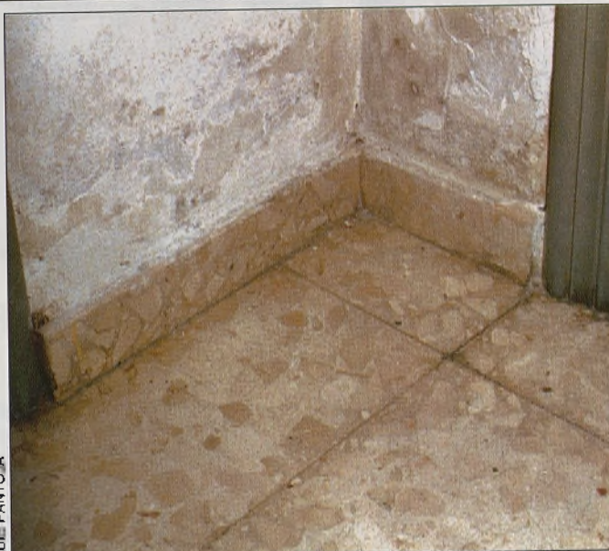
La situación del centro médico de Polán es "insostenible". El alicatado se está cayendo y los suelos se han hundido
