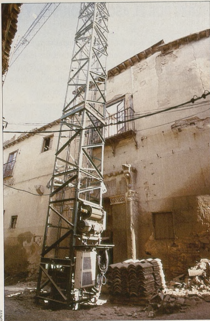
Los expertos llaman la atención sobre las obras que se hacen en el palacio gótico de la calle Recogidas.
