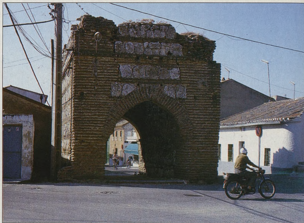
De estilo mudéjar, la puerta de Ugena del antiguo recinto amurallado de Illescas, necesita una urgente restauración y actuación sobre su entorno.
