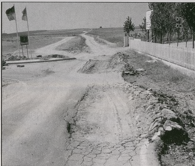
Inprocosa reclama también el pago de otras obras realizadas en el Señorío de Illescas, como la eliminación de socavones como el que aparece en la fotografía.
