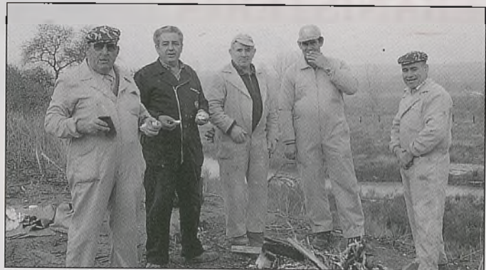
EL PUEBLO DEL GUADARRAMA, MAS SEGURO. Miembros de la brigada de mantenimiento del Ministerio de Obras Públicas y Transporte están instalando una barrera de seguridad de hormigón en el puente del Guadarrama, situado en el kilómetro 12,400 de la N-403 en el término de Rielves. Según fuentes del MOPT, estas obras de conservación para la mejora de la seguridad vial son una solución provisional, puesto que la definitiva será la construcción de un nuevo puente y una variante que supondrán una inversión superior a los 630 millones de pesetas.
