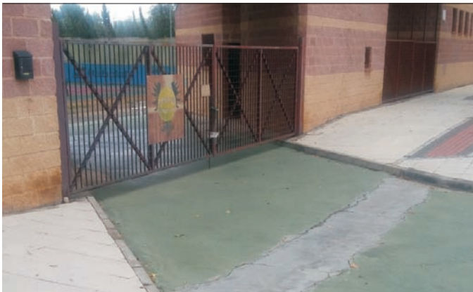
Pequeños detalles que hay que corregir, como vemos en la puerta de las pistas de tenis (velódromo) se debe rebajar a ambos lados el acerado para lograr total accesibilidad.
