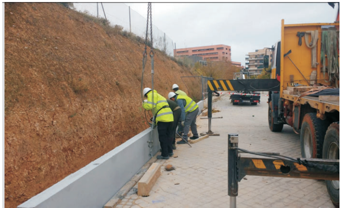
Como muestra la imagen ya han comenzado las obras para lograr el vallado de todo el perímetro de la pista de atletismo, una obra esperada que se financiará con el convenio JCCM-Ayuntamiento.
