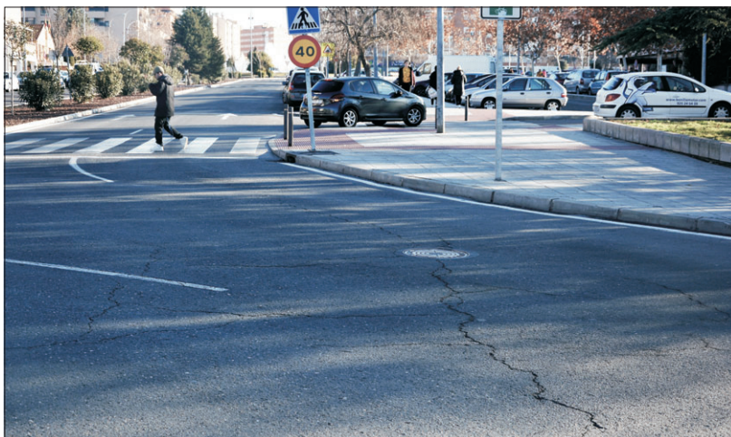
En el plan de asfalto algunas rotondas están sin hacer y este es el aspecto con grietas.
