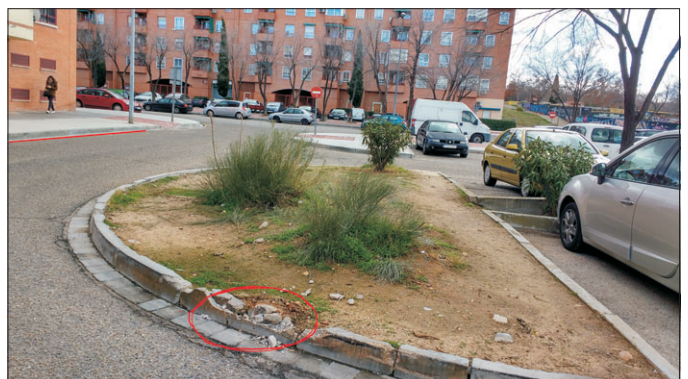
Si no se prohíbe aparcar en la línea roja el bordillo se va destruyendo por que los camiones no tienen radio de giro, se sabe pero no se toman medidas.
