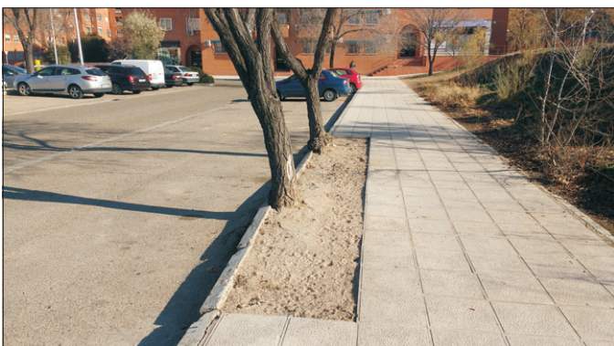
Otra muestra de que no se revisan los finales de obras, este acerado se realizó hace más de dos años y ahí sigue.
