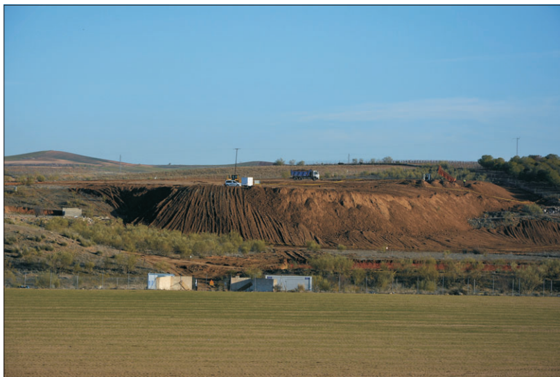
La Junta de Comunidades está tapando parte de los residuos de amianto.
