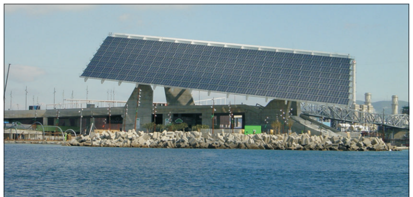
Fotovoltaica del Forum Barcelona.
