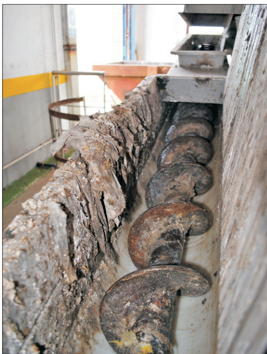
Uno de los mecanismos que se suelen averiar por las toallitas.
