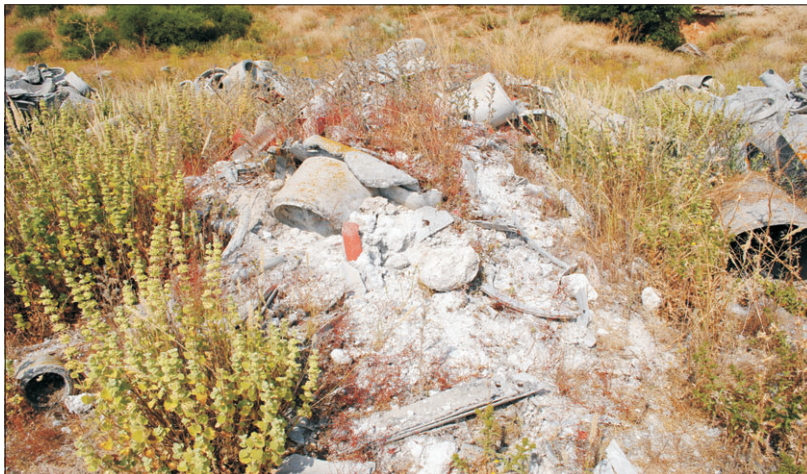
Los restos de amianto aún siguen en este estado cerca de nuestras viviendas.
