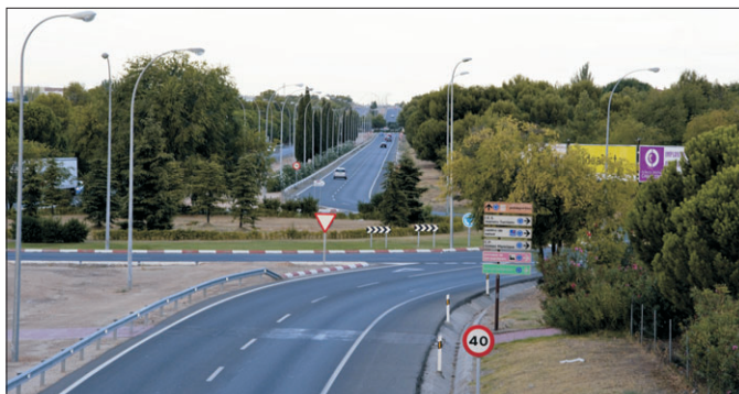
Perspectiva del tramo entre Guadarrama y Ventalomar, falta iluminación.
