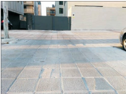
Estado del acerado.
