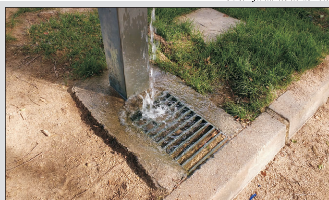
Los desagües de las fuentes no pueden estar atascados continuamente.
