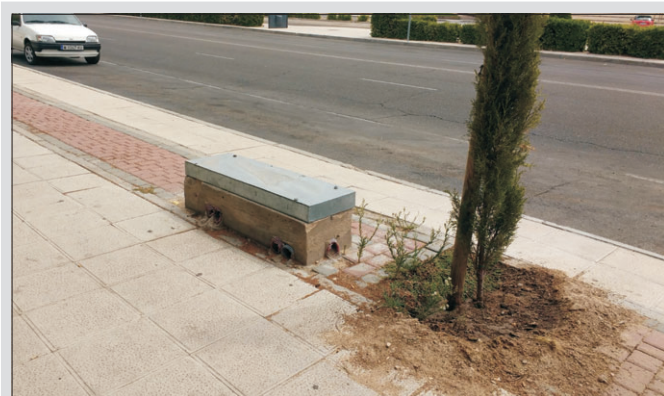
Los registros de los armarios podrían forrarse de madera para bancos.
