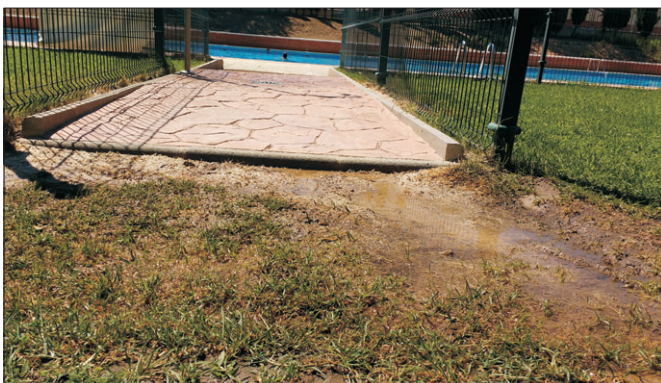
Estado lamentable por una deficiente obra
