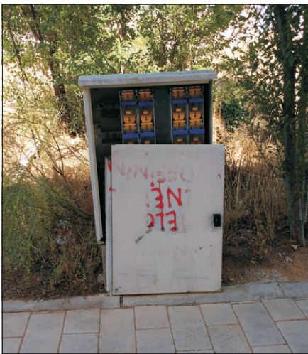
Los armarios abiertos son un peligro latente.
