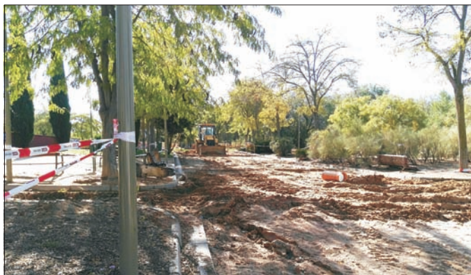
Se están canalizando las aguas de los paseos y poniendo un firme compacto.
