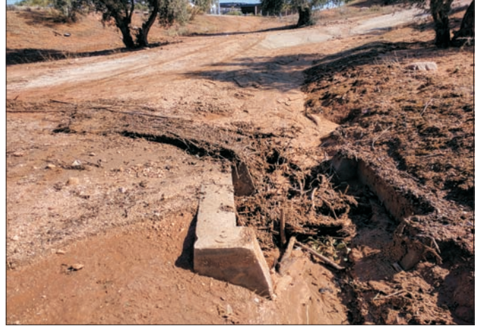
Zona destrozada sin restaurar.
