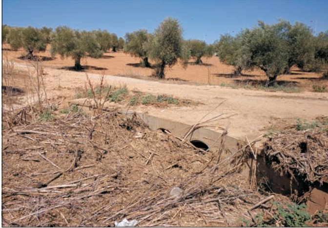
Tuberías del puente cegadas después de la tormenta.
